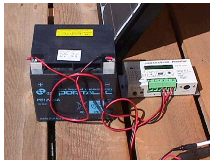
バッテリーとコントローラ
